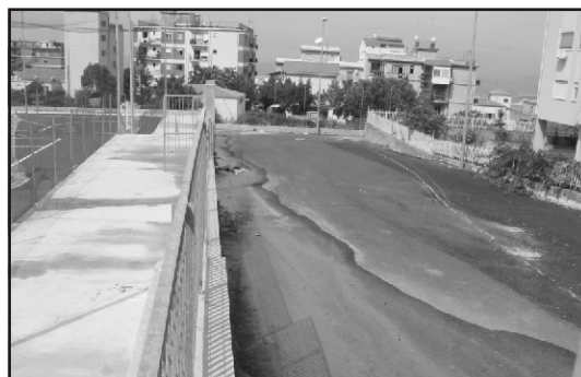
INFILTRAZIONI RUSCELLO NEI CAMPI SPORTIVI
